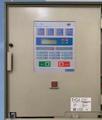
تابلو کنترلر اتوریکلوزر ۲۰ کیلو ولت مدل: BR-10RN
