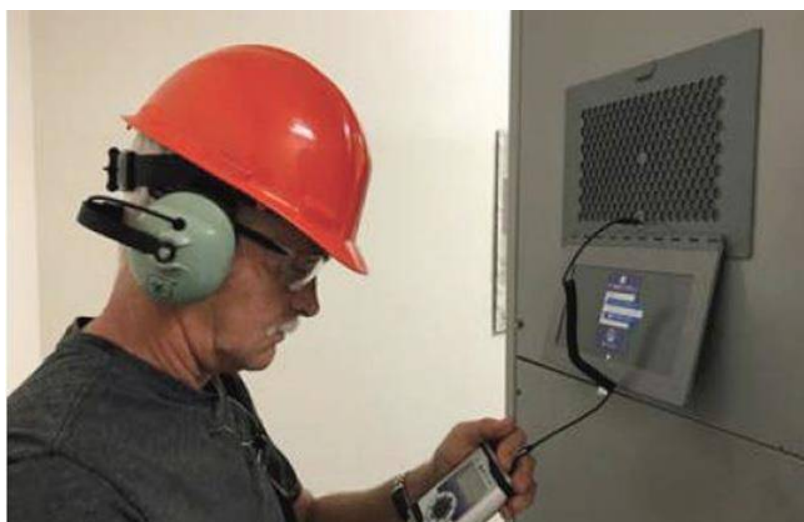
شکل ۴-۲۵: بازرسی سوئیچگیر با یک سنسور تخلیه جزئی نصب شده دائمی مبتنی بر فراصوت
